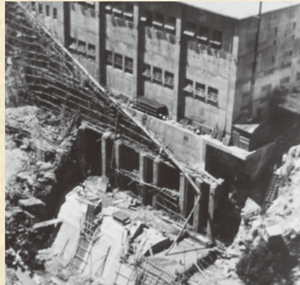
建設中の黒部川第三発電所。昭和15(1940)年発電開始(提供:関西電力)
