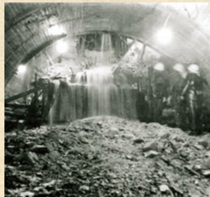
4℃の冷水が最大で毎秒660ℓも噴出した破碎帯(提供:関西電力)
