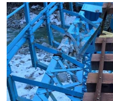
R6.1. 黒部峡谷鉄道 鐘釣橋 落石による被害
